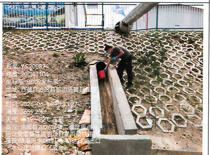
察达隧道出口污水厂处理厂
