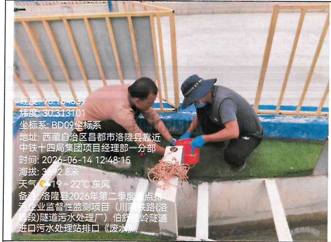
伯舒拉岭隧道进口污水厂处理厂
