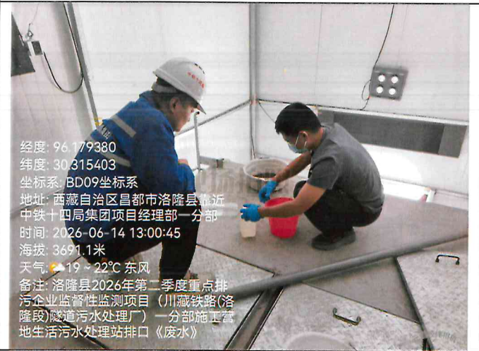
一分部施工营地生活污水处理站
