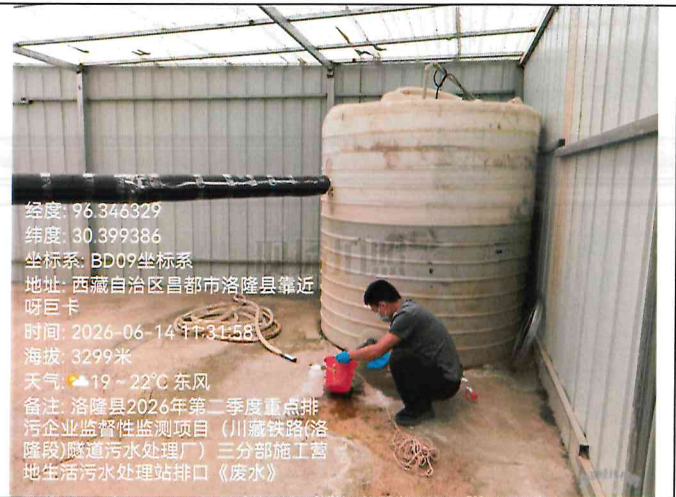
三分部施工营地生活污水处理站
