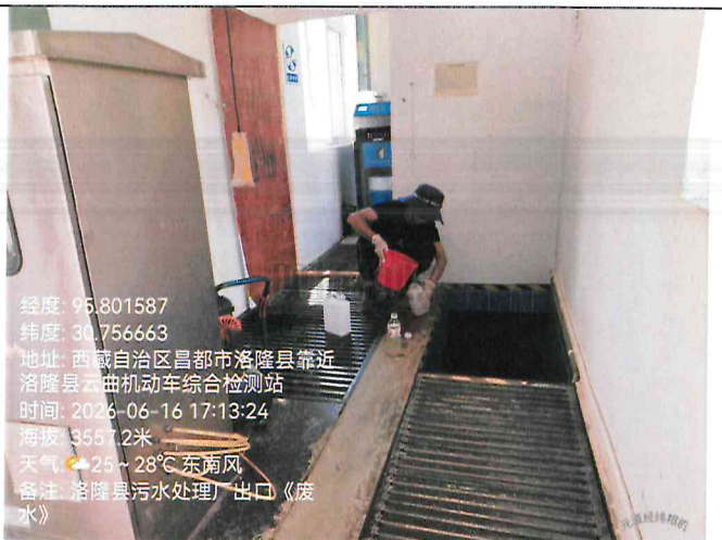
洛隆县污水处理厂出口（废水）
