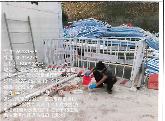
二分部施工营地生活污水处理站
